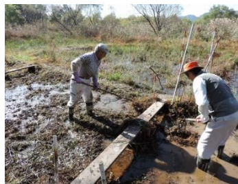
湿地の攪乱（第3工区）
