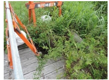
老朽化して腐食した橋
